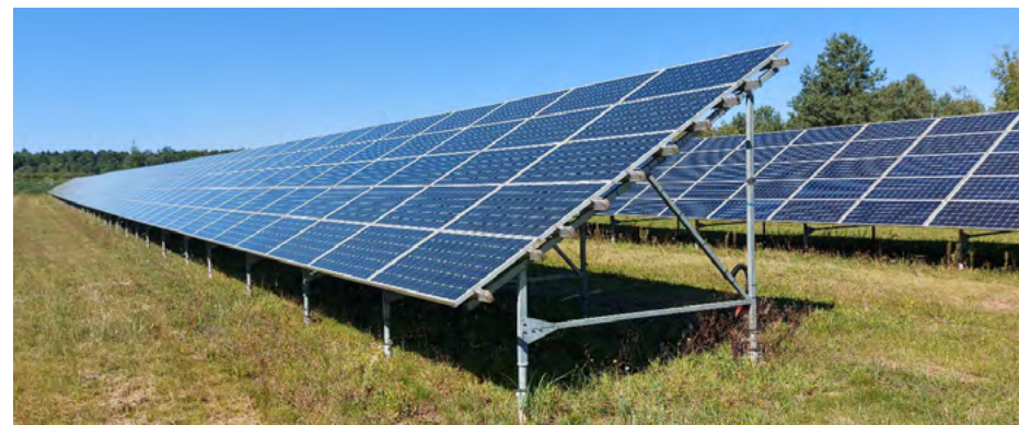
Obr.1: Fotovoltaická elektrárna Ralsko (autor: Jan Cihlář)
